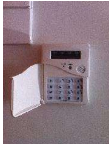
Alarma Interior de departamento
