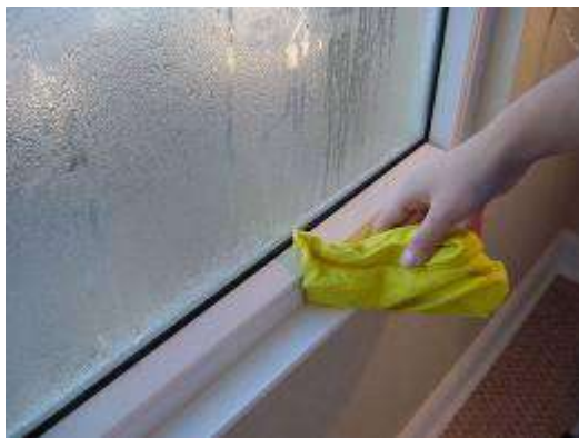
Seque la humedad producto de la condensación (Especialmente en ventanales).
