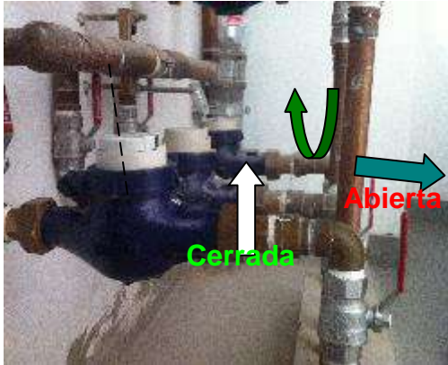
Agua Fría: en caso de emergencia (filtración), cierre inmediatamente la llave de paso.
