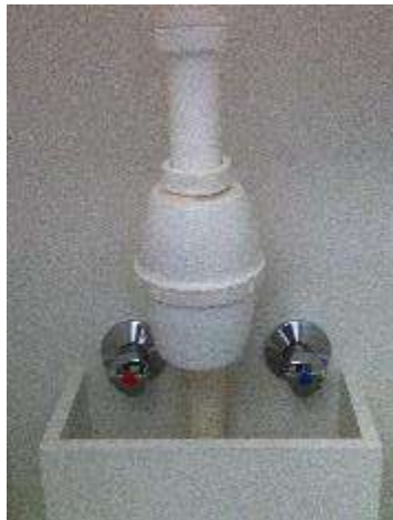
Desagüe Lavaplatos Loggia.
