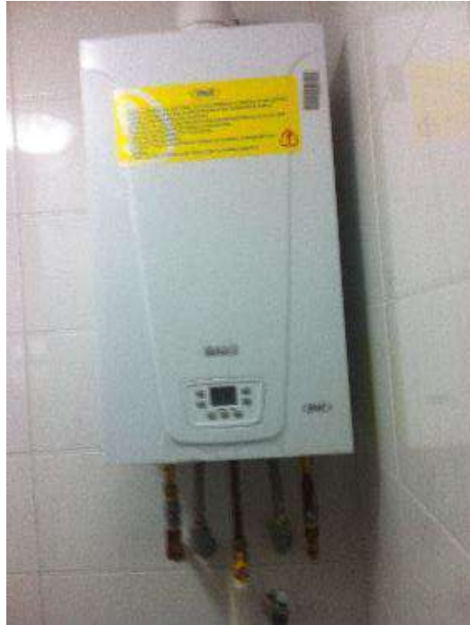
Caldera Calefacción/ agua caliente.
