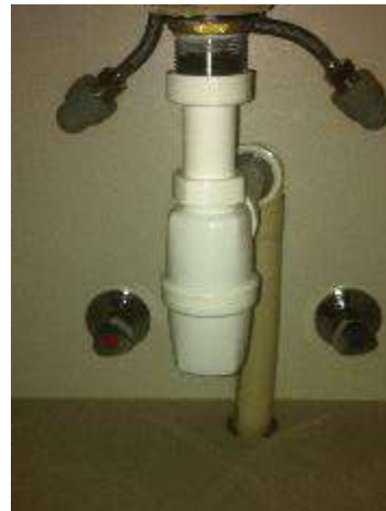
Desagüe Lavaplatos Cocina.
