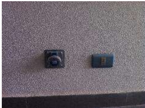
Enchufe conectado a Red de Emergencia.
