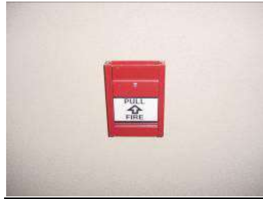
Alarma para Emergencias
